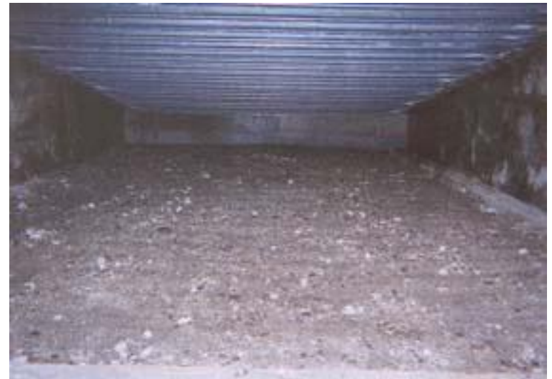
デッキプレート下の地面は濡れており、プレートの突起に沿って落ちる水滴の跡が縞状に残っている
