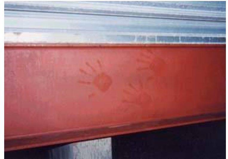
梁に結露発生（手形跡がつけられる）
