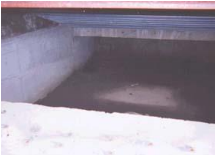
デッキプレート下のピット部分には発生した水滴が落ち、水が溜まっている
